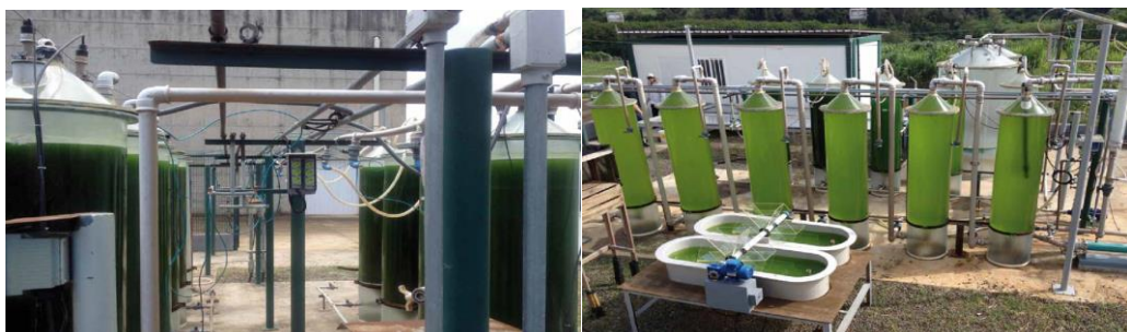
Figura 3- Estação de tratamento de efluentes
